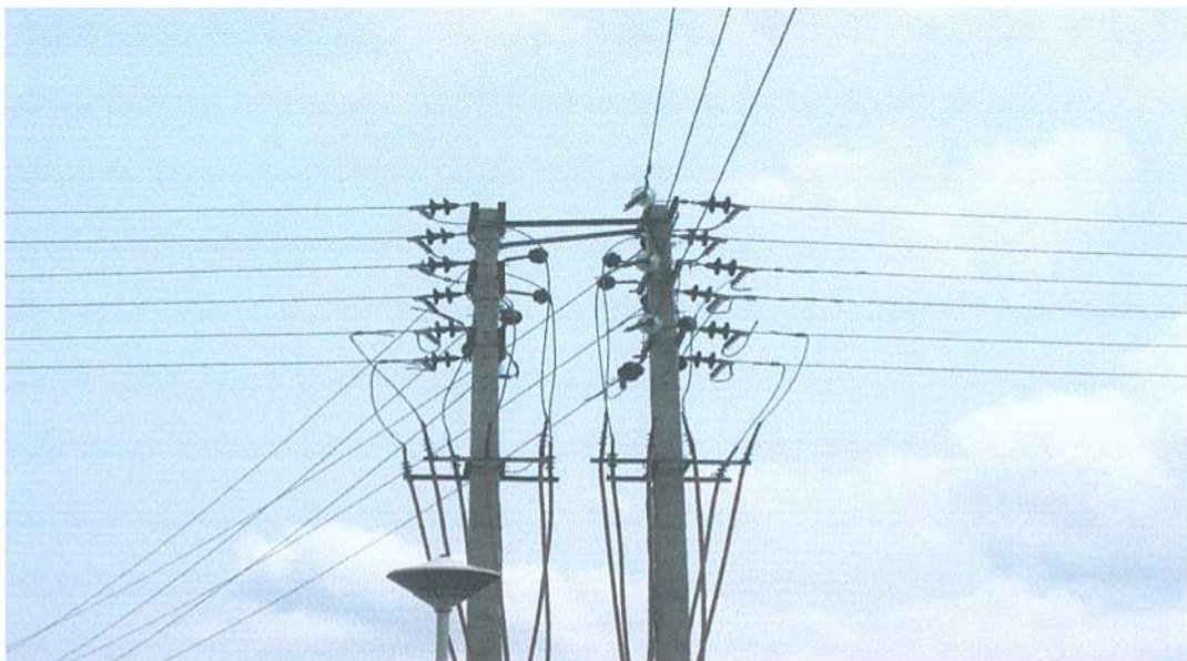
پروژه رینگ خطوط برق محمودآباد (کارفرما: شرکت توزیع نیروی برق غرب مازندران)
