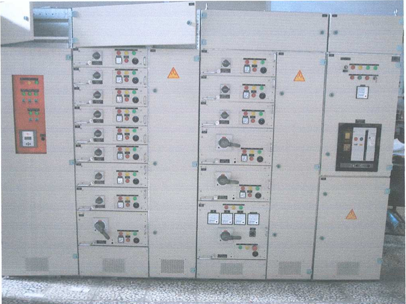
تابلو کشویی صنایع پتروشیمی بیستون
