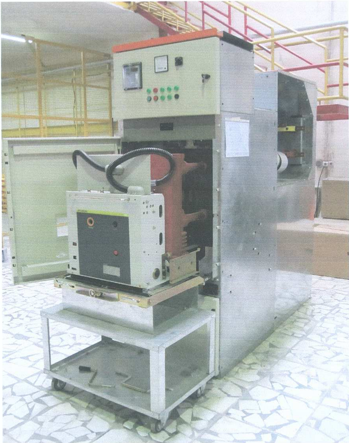
تابلو فشار متوسط کشوئی طرح یونیسف
