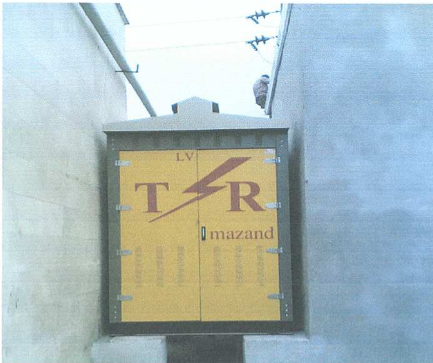
پروژه پست کمپکت بیمارستان بابلسر
