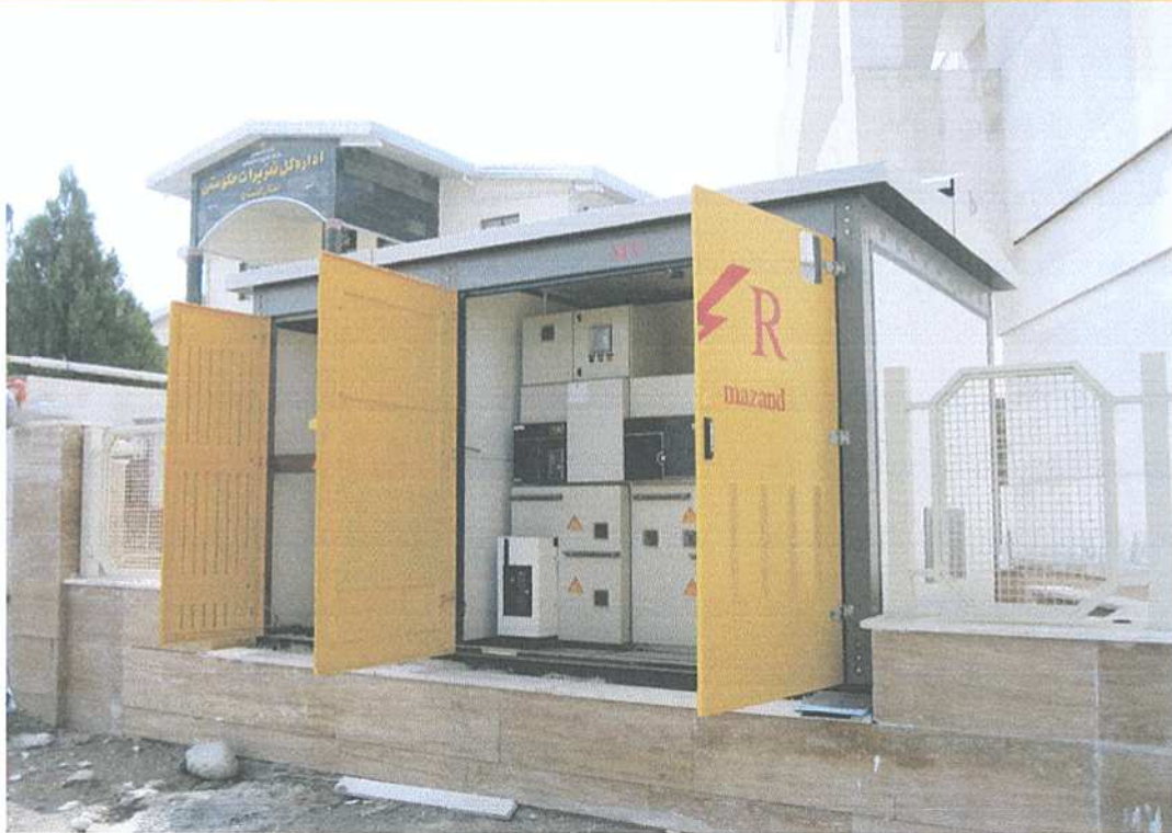
پروژه پست کمپکت مسکن و شهر سازی گلستان
