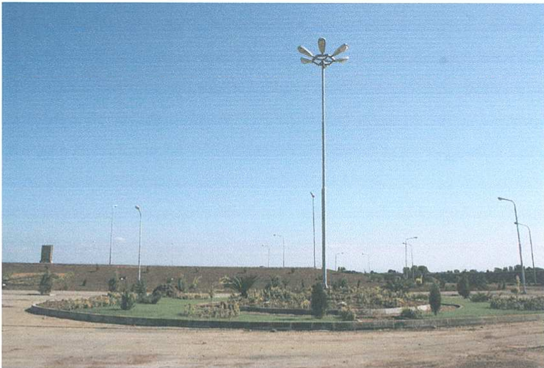
پروژه روشنایی تصفیه خانه جویبار (کارفرما: شرکت آب و فاضلاب استان مازندران)
