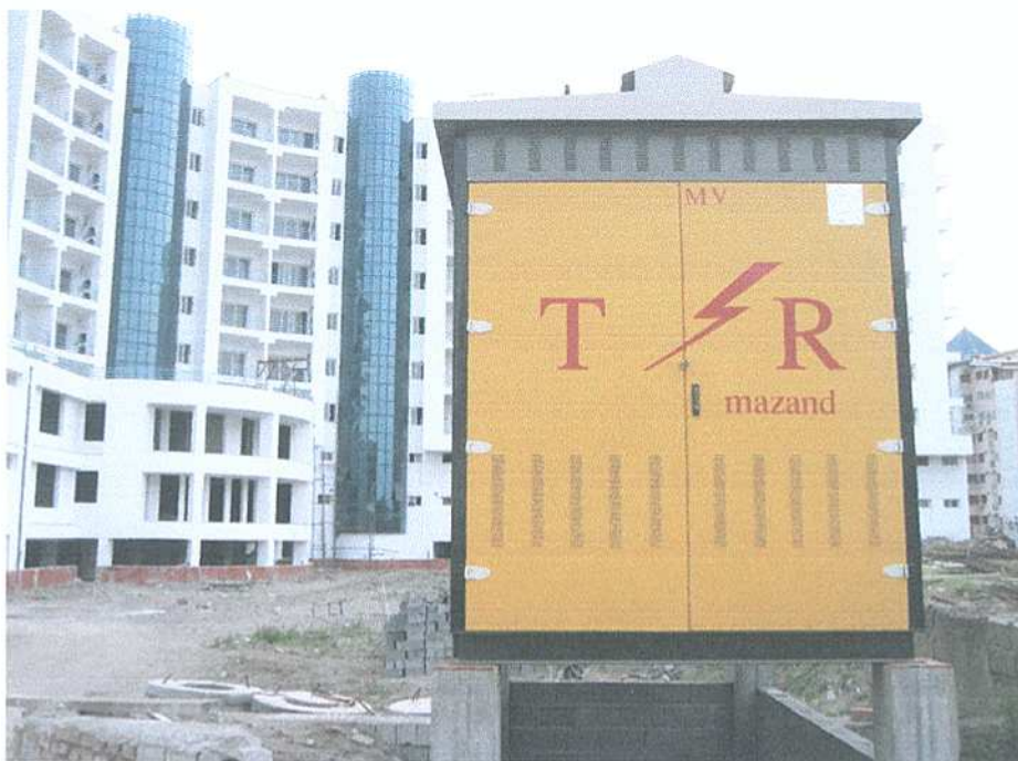
پروژه پست کمپکت مجتمع ساحلی رویان سنتر
